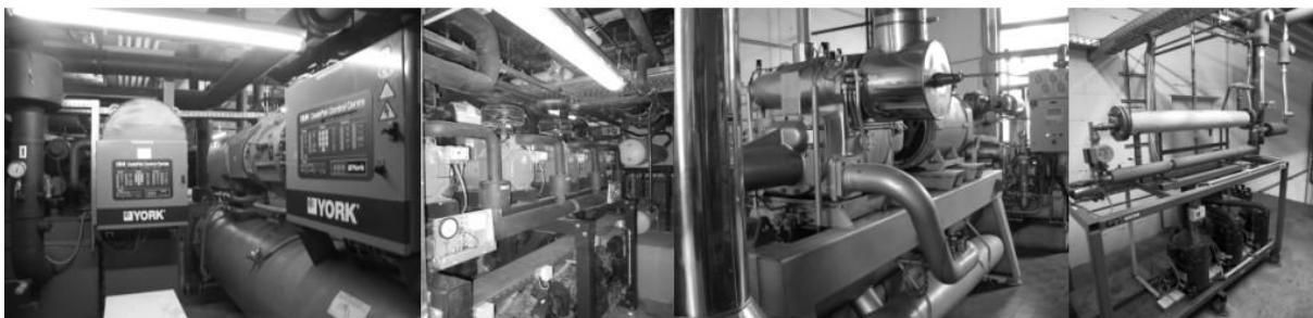
Abbildung 5.2 Beispiele für analysierte Kälteanlagen in Mannheim in unterschiedlichen Branchen
